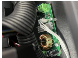
Panel de control de calefacción
